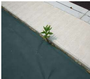
ボンド不使用、隙間からの 雑草発生
